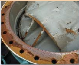
A korrodált pillangószelep – felújítás előtt és után
